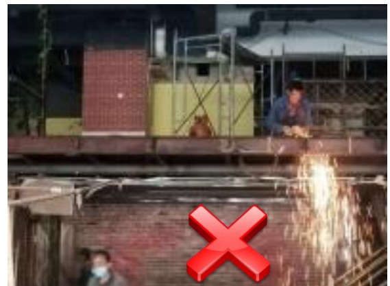
图例 33：动火作业未做安全防护措施
